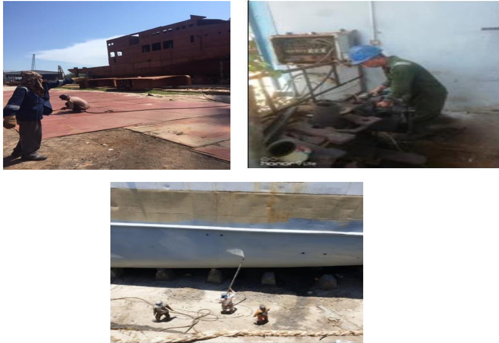
Gambar 4.1 Pekerja yang tidak menggunakan helm dan earplug
